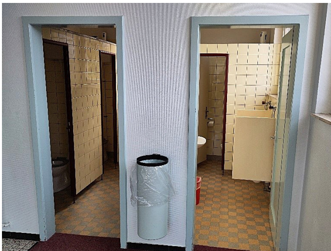
Altes Schulhaus EG: WC-Anlagen Mädchen und Knaben
